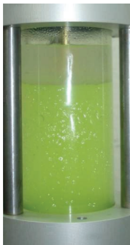
Kältemittel- UV-Gemisch durch Wasser verunreinigt.
